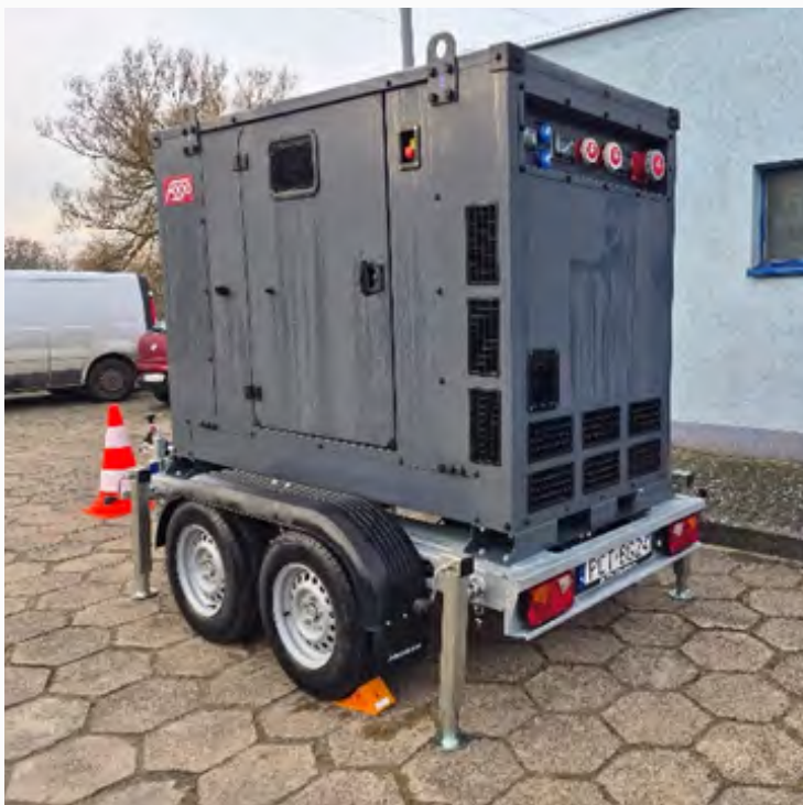
Mobilny agregat prądowórczy FOGO o mocy 78kW.
