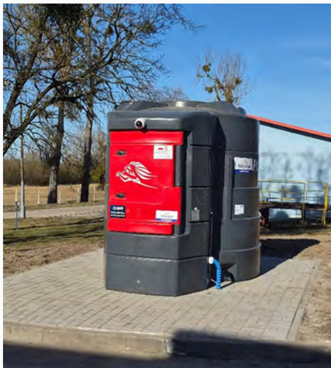
Stacja paliw o pojemności 5000 l
